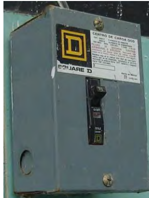
Figura 5 Centro de carga con su interruptor termomagnético
