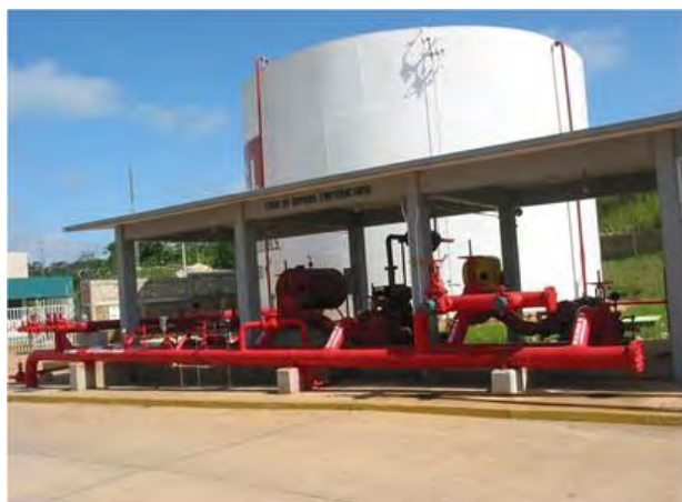
Figura 1 Instalaciones contraincendio Pemex Región Sur
