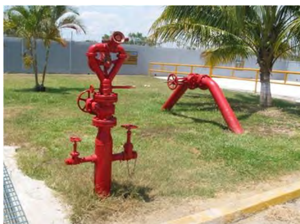
Figura 2 Instalaciones contraincendio Pemex Región Sur
