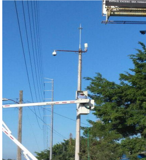
Figura 1. Poste y cámara de video, ubicada a una distancia menor a la estipulada a las líneas de transmisión.
