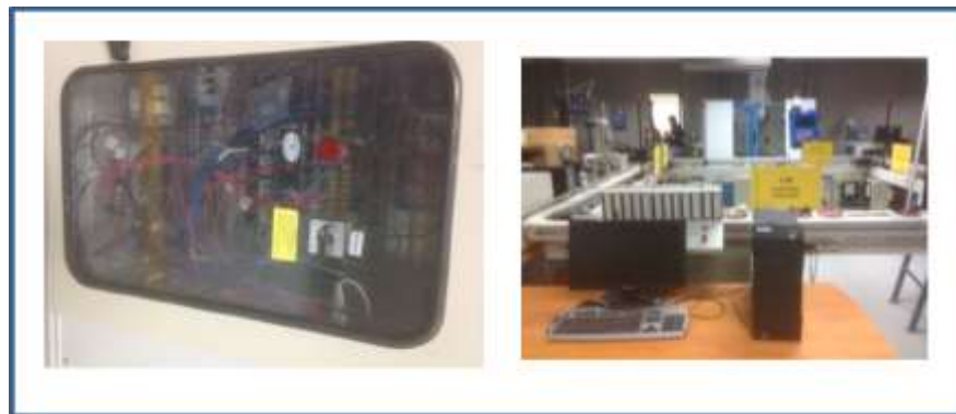
Figura 5. Panel de Cableado de comunicación del CIM y estaciones del CIM.
