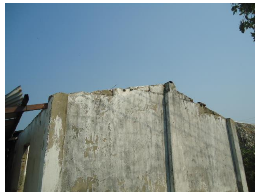
Figura 15. Techos colapsados Fuente: Álbum fotográfico propio.
