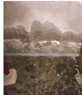
Figura 13. Presencia de humedad y salitre. Álbum fotográfico propio.
