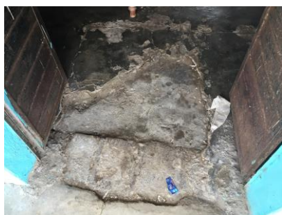
Figura 3. Desprendimientos. Fuente: Álbum fotográfico propio.
