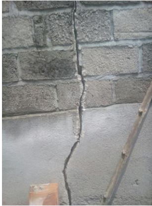
Figura 8. Fisuras y grietas en muros. Fuente: Álbum fotográfico propio.
