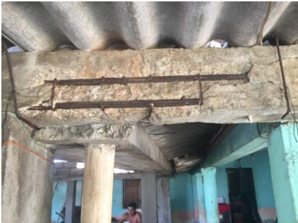
Figura 11. Corrosión del acero. Fuente: Álbum fotográfico propio.
