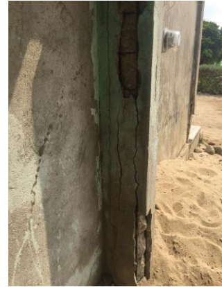
Figura 10. Desprendimientos Fuente: Álbum fotográfico propio.
