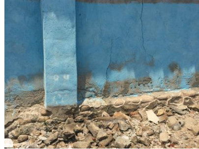
Figura 6. Fisuras y grietas en muros Fuente: Álbum fotográfico propio
