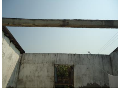
Figura 5. Perdida de cubierta. Fuente: Álbum fotográfico propio.
