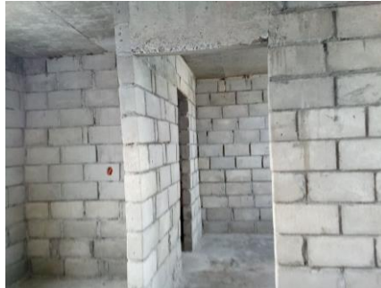
Figura 12. Falta de soportes estructurales Fuente: Álbum fotográfico propio.
