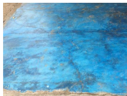
Figura 4. Fisuras y grietas en pisos Fuente: Álbum fotográfico propio
