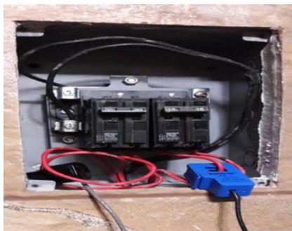
Figura No. 3. Conexión de sensores no invasivos en centro de carga.
