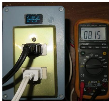
Figura 10 sobrecarga generada en el tomacorriente A1
