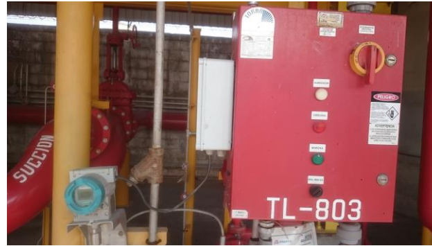
Figura 10.-Nuevo sistema de control instalado.
