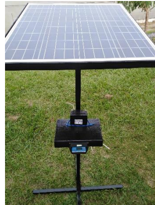
Figura 16. Instalación completa de los componentes eléctricos y electrónicos.
