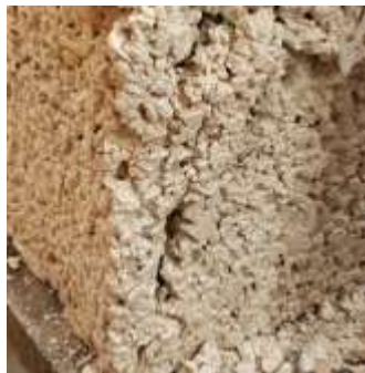
Figura 8. Falla vertical en la pared externa de BP
