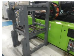
Figura 9. Rack de moldes fijo en moldeadora.
