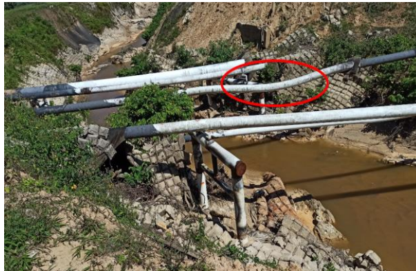
Figura 2. Sistema de tuberías de transporte de hidrocarburos. Oleoducto de 10'' de diámetro con deflexión plástica.
