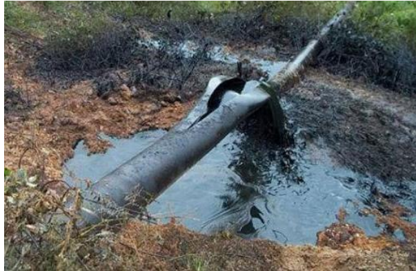
Figura 1. Falla típica de un oleoducto.
