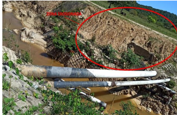
Figura 3. Zona erosionada que disminuye el soporte necesario para las tuberías, causando deformaciones excesivas en las tuberías.
