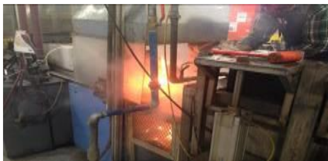
Ilustración 2 Conato de Incendio
