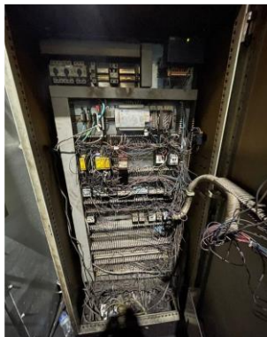
Ilustración 3; Exceso de suciedad en el interior de tablero de control. (Fuente Propia)
