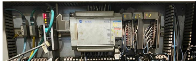
Ilustración 7; Controlador utilizado actualmente. (Fuente Propia)
