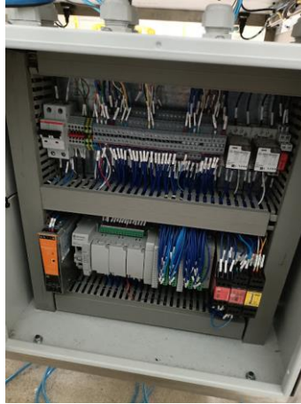
Figura 5. Gabinete de control.
