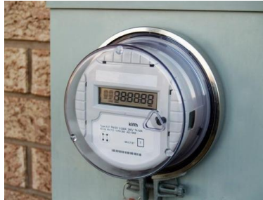
Figura 4.- Medidor bidireccional de sistema de interconexión
