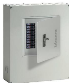
Figura 3.- Tablero de distribución eléctrica
