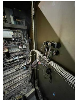
Ilustración 4; Daño en canaletas y cableado fuera de lugar. (Fuente Propia)
