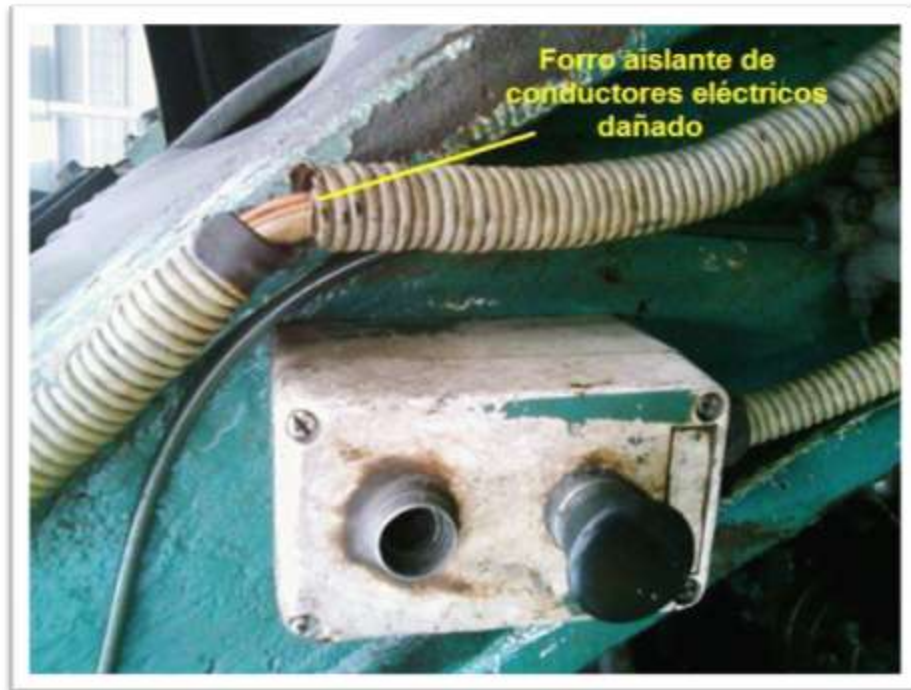
Figura 5. Fuentes de peligro (Anomalía en la alimentación eléctrica).
