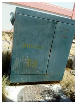
Figura 1. Transformador de distribución .
