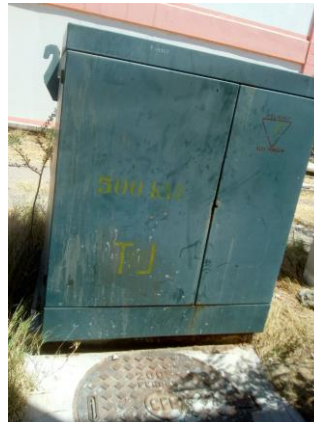
Figura 1. Transformador de distribución .
