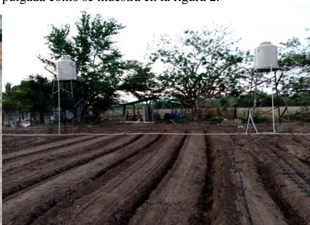
Figura 3. Tubos PVC conectados a tinacos.
