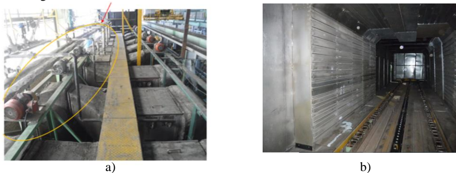
Figura 6. Reconfiguración del horno de convección. a) Modificación en la posición de las turbinas. b) Modificaciones al Interior del horno.
