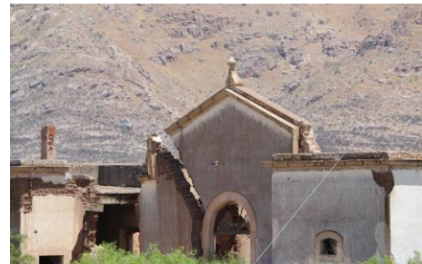
Ilustración 3 Casa del Administrador y tienda de raya con un deterioro muy lamentable. Fuente: JNVM (2020)
