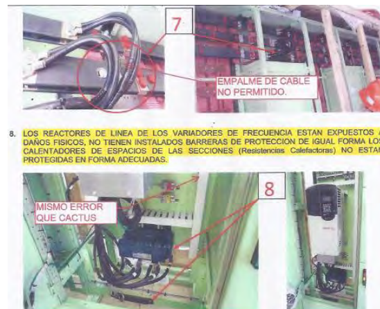
Figura 3. Observaciones del inspector al panel posterior del CCM.
