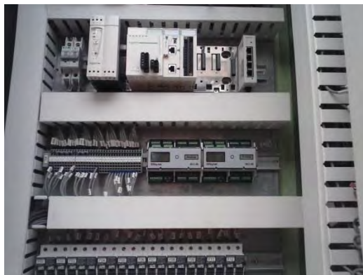
Figura 9. Sistema de control y monitoreo de puntos calientes.
