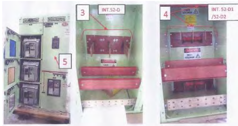
Figura 2. Tablero principal de interruptores.
