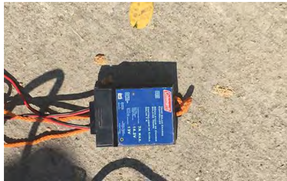
Figura 4. Conexión de regulador de carga de la energía captada por los paneles solares, protegiendo la batería de sobrecargas. Fuente: elaborado por autores.
