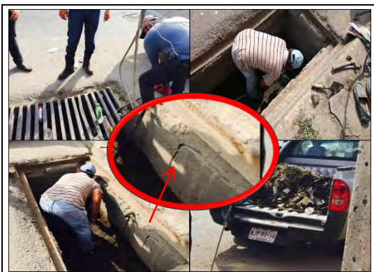
Figura 2. Mantenimiento del colector y recolección de
