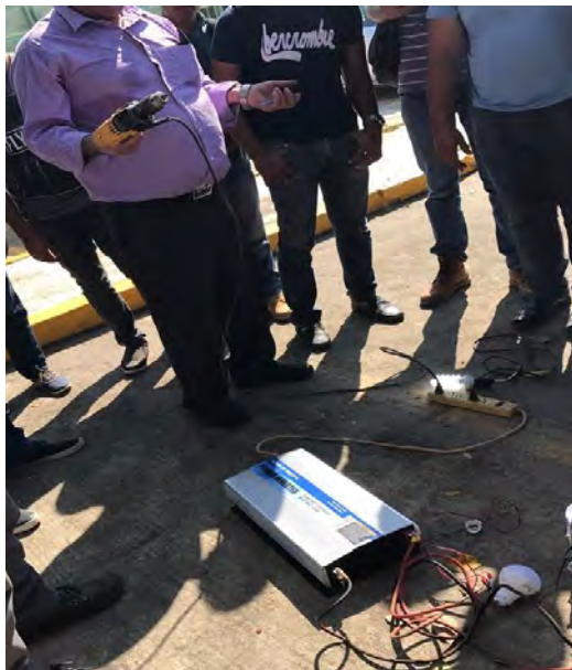
Figura 6. Finalmente podemos utilizar la energía eléctrica generada por los paneles solares en el funcionamiento de las herramientas eléctricas, utilizadas en cualquier obra de edificación.
