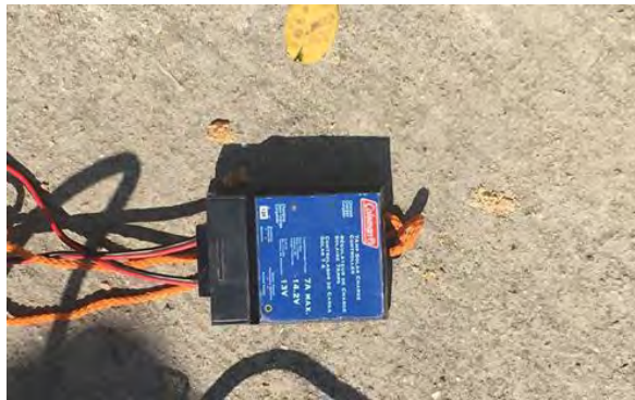
Figura 4. Conexión de regulador de carga de la energía captada por los paneles solares, protegiendo la batería de sobrecargas. Fuente: elaborado por autores.
