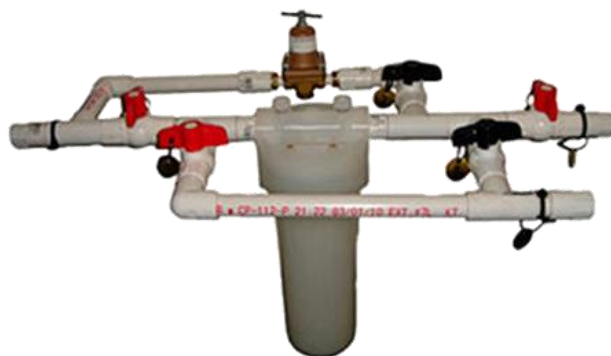
Figura 1.3 Ensamble con tubería PVC y sistema de retro lavado
