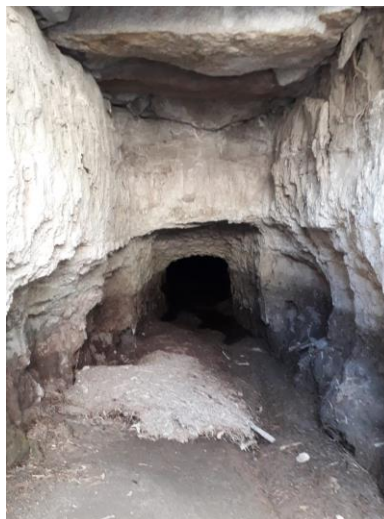
Figura 3 Interior de la galería, azolvada, se observa el sistema de trabajo del socavón y el techo de cantera.
