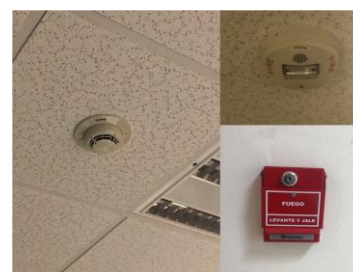
Figura 4 Sistemas de alarma
