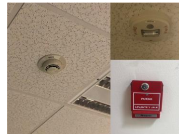
Figura 4 Sistemas de alarma
