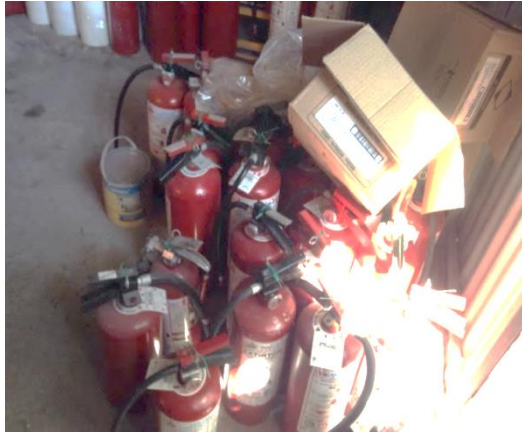
Imagen 3. mala distribución de extintores
